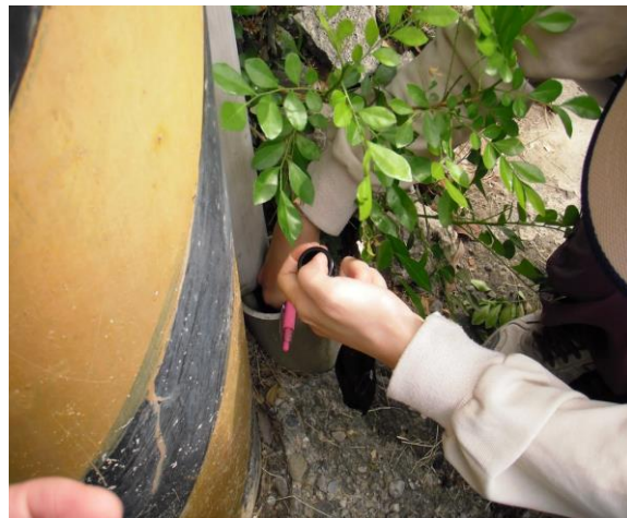
地下電纜引上管
