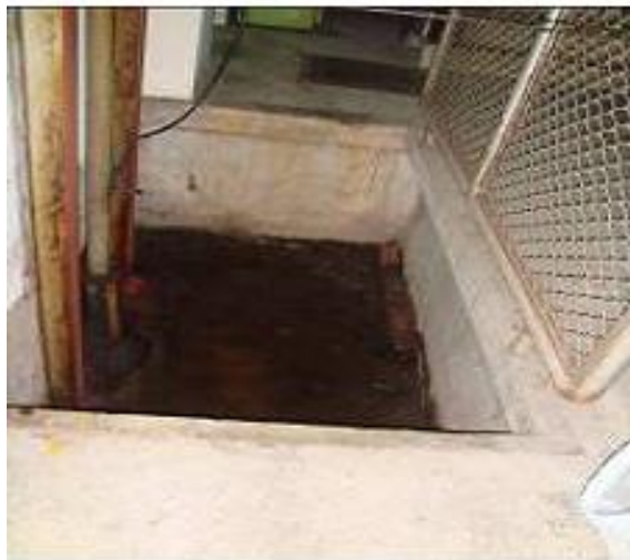
地下室之升降梯孔積水
