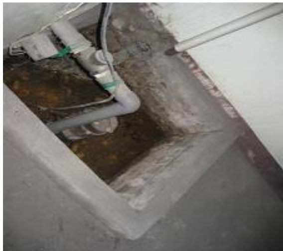
地下室儲水槽
