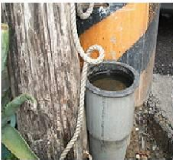
台電地下電纜引上管
